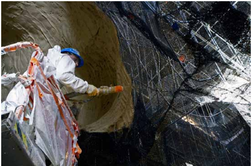
Sur ces cages métalliques, les ouvriers projettent deux couches de mortier paysage réalisé à partir de matières minérales et liants naturels. © SYCPA – Sébastien Gayet
