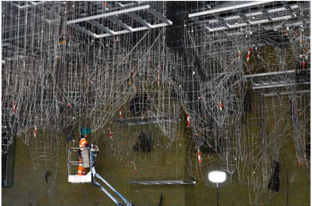
Le squelette de la grotte recrée réalisé est ensuite fixé au plafond du bâtiment de la réplique. © SYCPA
